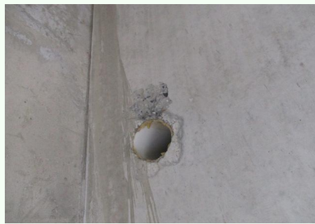
사진2 - 콘크리트 거더 파손(여수대교)
